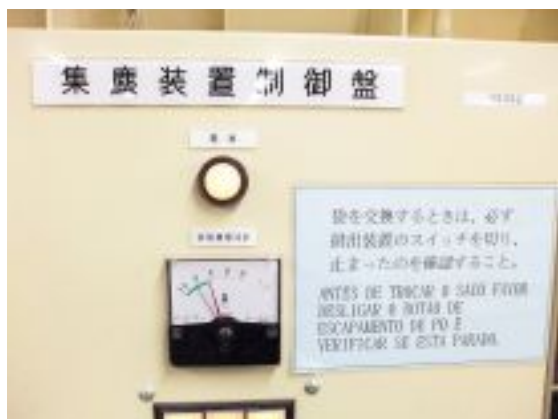
写真19：集塵装置制御盤
